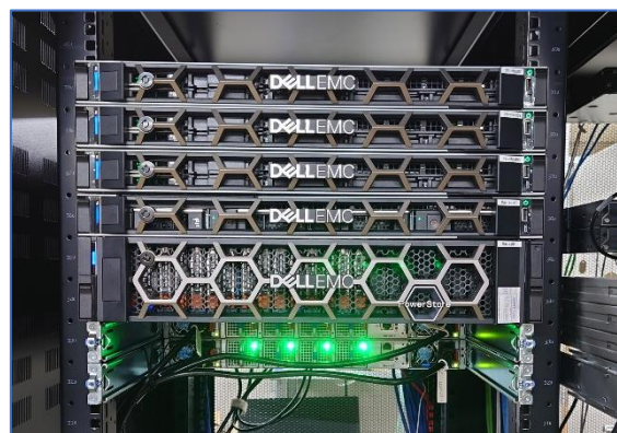
図5 サーバラック
